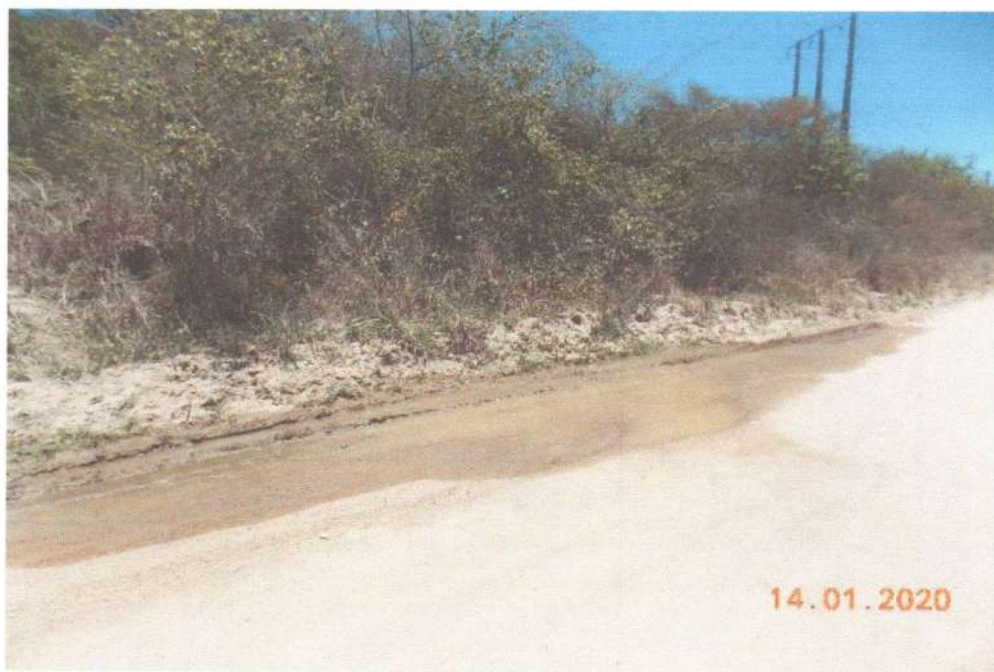
FOTO 11 – Local com acúmulo de água na Estrada de São Pedro próximo ao trecho que corta o Rio São Vicente. FONTE: Aluisio Sales, 2020.
