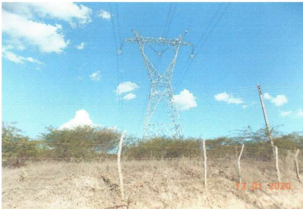
FOTO 5 – Linha de Transmissão de 230 kV da CHESF na área do terreno onde será implantado o empreendimento. FONTE: Alúcio Sales, 2020.
