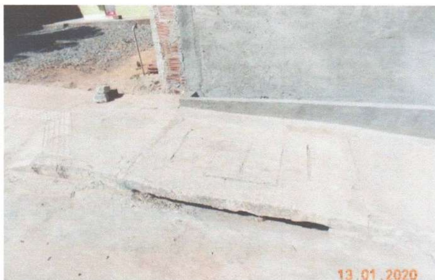
FOTO 29 – Sistema de drenagem pluvial em uma rua na Comunidade de São Vicente. FONTE: Aluísio Sales, 2020.
