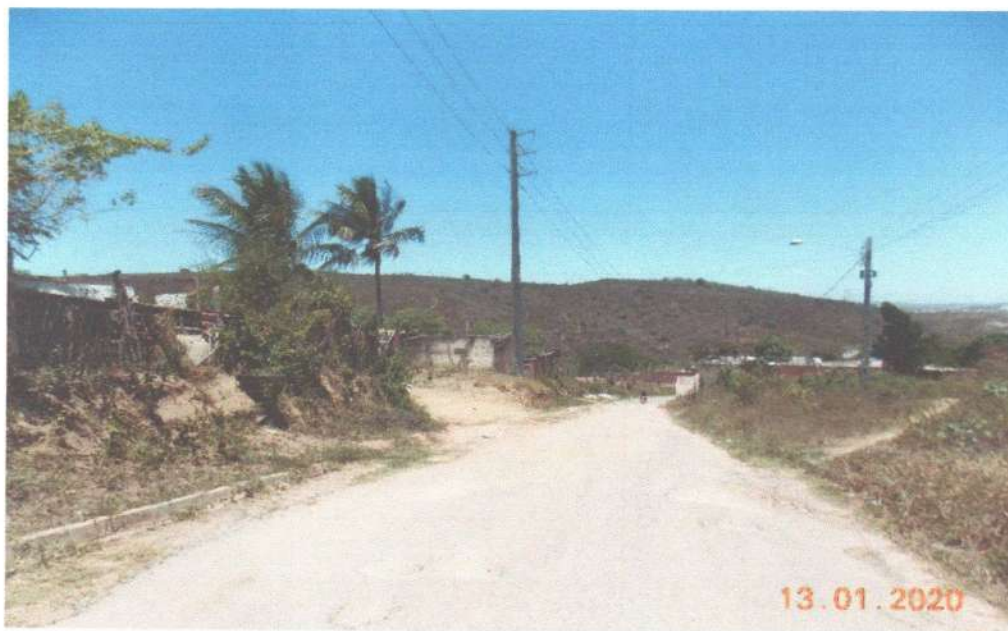
FOTO 7 – Trecho pavimentado da Estrada de São Pedro com muitos buracos. FONTE: Aluísio Sales, 2020.
