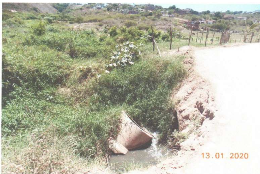
FOTO 10 – Bueiro danificado em trecho da Estrada de São Pedro que corta o Rio São Vicente que ocasionou o desmoronamento lateral do corpo estradal . FONTE: Aluisio Sales, 2020.
